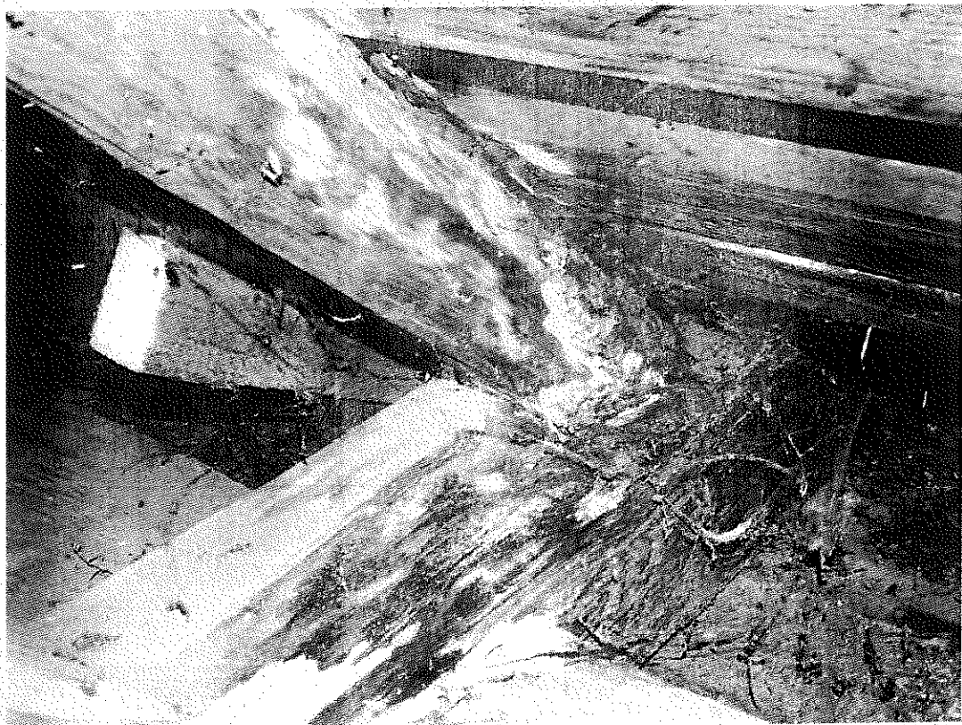
Fot.[18] Grzyb domowy właściwy ( Serpula lacrymans ) na konstrukcji więźby i legara Fot. autor.
