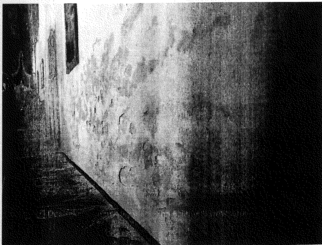
Fot.[17] Destrukcja tynku – wysolenia na ścianach wewnętrznych. Fot. autor
