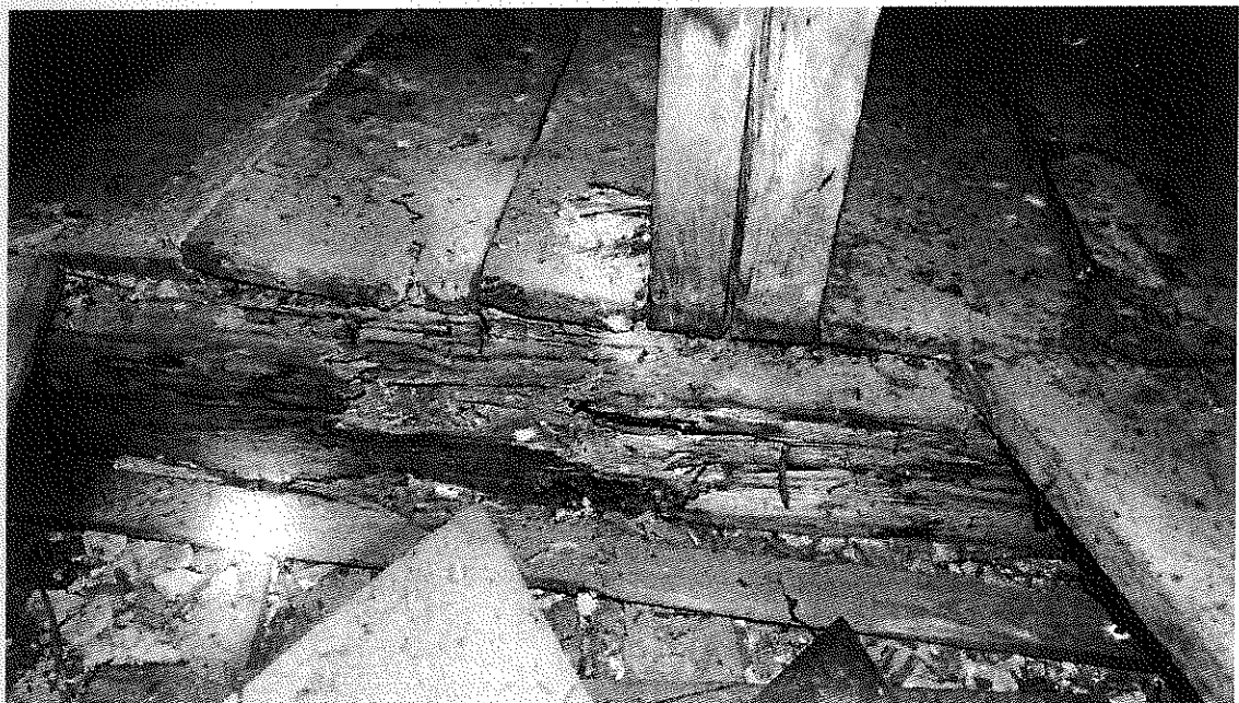
Fot.[7] Korozja biologiczna fragmentu legara podłogowego. Fot. autor.
