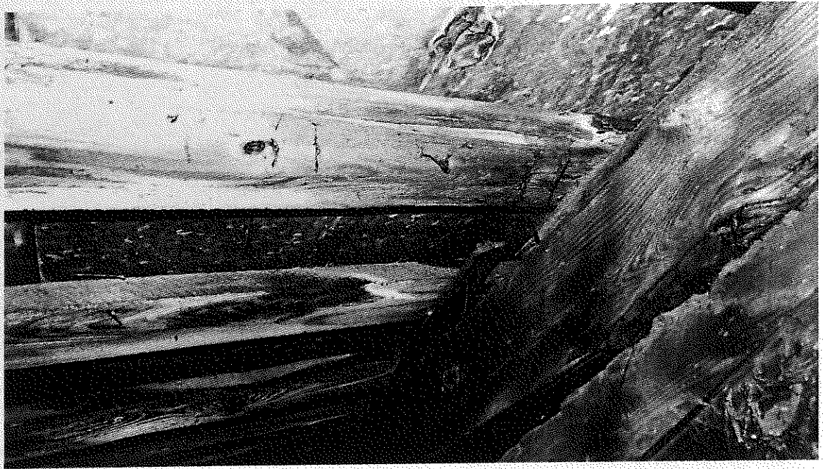
Fot.[4 ] Korozja deskowania oraz pokrycia dachu. Fot. autor.
