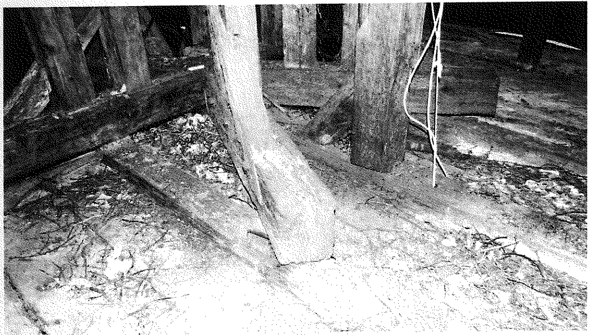
Fot.[5] Korozja biologiczna konstrukcji wieży – widoczna destrukcja spowodowana przez owady oraz ubytki w strukturze drewna. Fot. autor.
