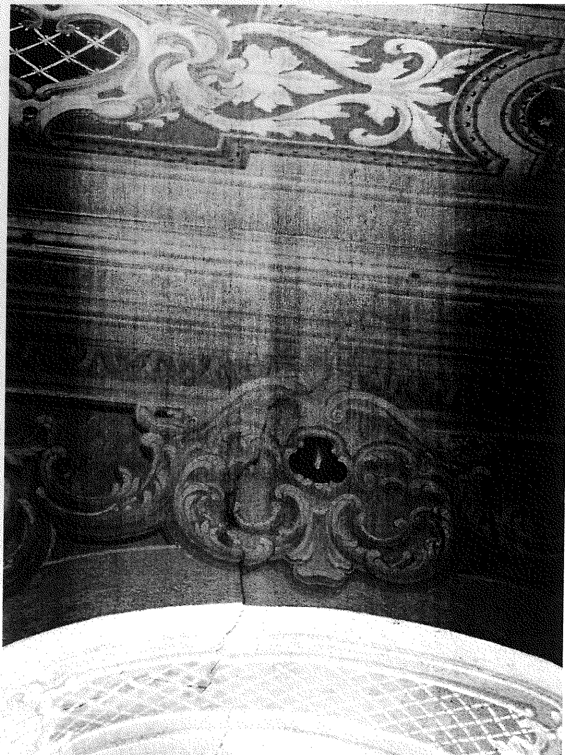
Fot.[12] Pęknięcia nadproża łukowego nad otworem okiennym – widok od wewnątrz. Fot. autor.
