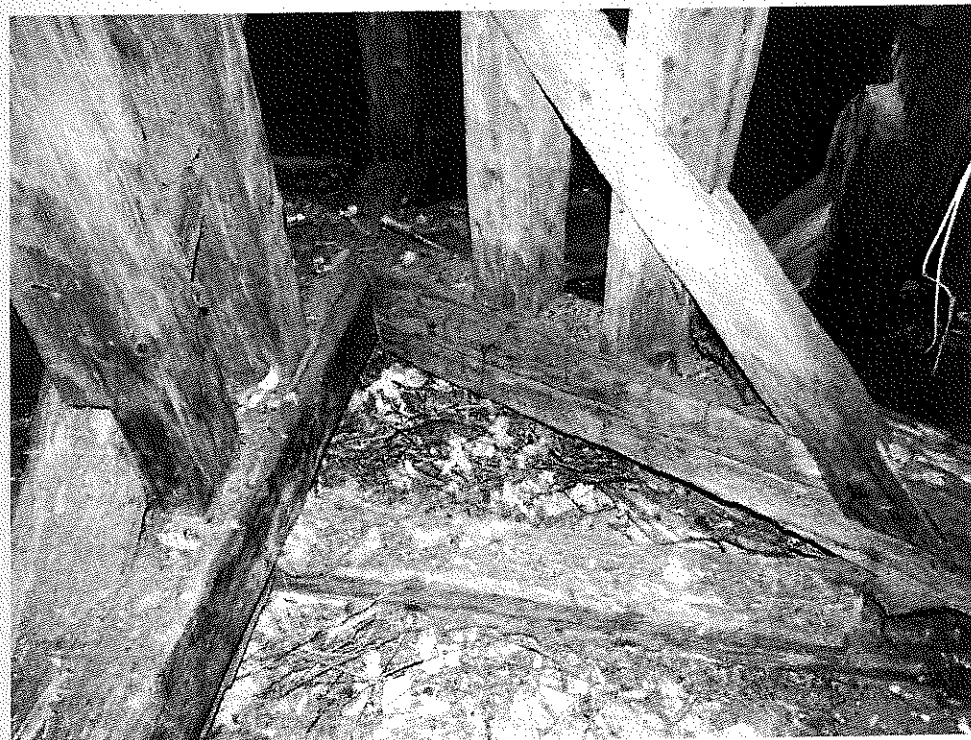
Fot.[25] Kołatek uparty ( Anobiumpertinax L.) - zaatakowana zawilgocona i opanowana przez grzyb podstawa konstrukcji sygnaturki. Widoczne otwory z usypaną mączką drzewną co świadczy o aktywności owadów. Fot. autor.
